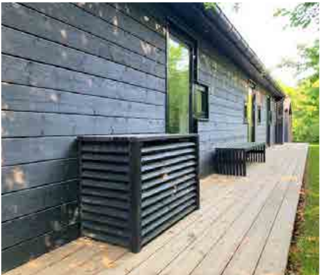
Skjulekasse til varmepumpe, malet
